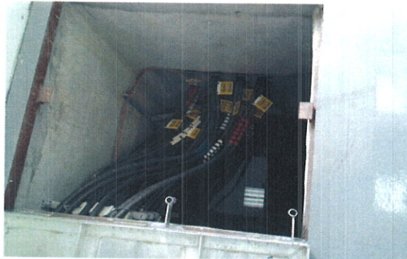
Salida de circuitos Subestación Llano Bonito
