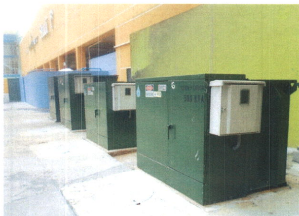
Los transformadores instalados en Westland Mall son de 1,000 kVA, 750 kVA, 500 kVA, 300 kVA y 150kVA
