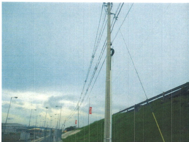
Línea trifásica de 115 kV que alimenta el patio de trenes de la Línea Uno del Metro.
