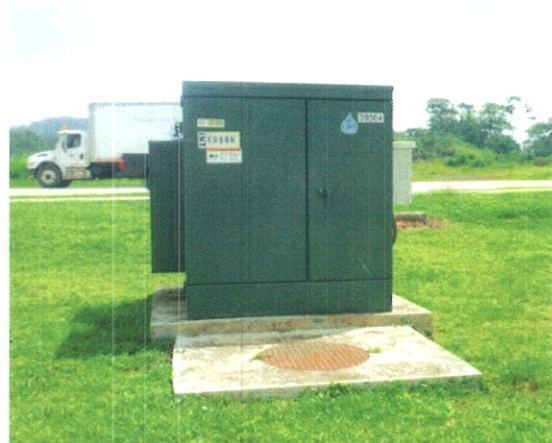
Transformador tipo gabinete de 1,000kVA, consalida de 480/ 277 V, instalado para el Edificio #9080
