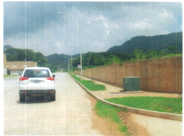
Transformador de 50 kVA para alumbrado público
