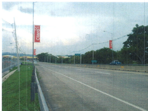
Aquí apreciamos a la izquierda la línea que alimenta el Metro, a la derecha la línea reubicada que alimenta Albrook Mall. Ambas líneas en las orillas del Corredor norte.
