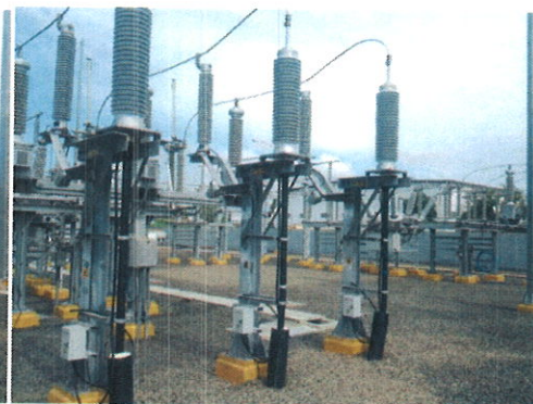
115-49. Final Soterrado SE Llano Bonito
