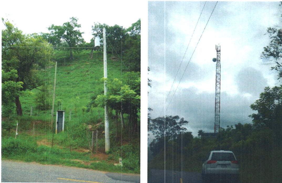
Vista final de la línea que suministra el servicio a la antena de telefonía móvil
