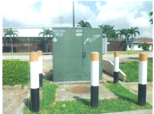
Transformador instalado de 1,000 kVA tipo gabinete
