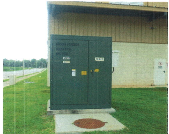
Transformador de 1,000 kVA instalado en los edificios #9100, #9095 y 9097
