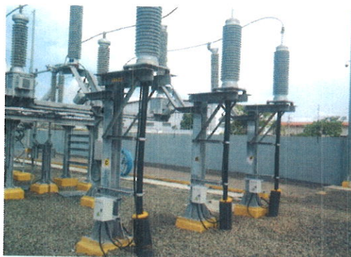
115-48. Final Soterrado SE Llano Bonito
